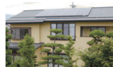
瓦屋根は全撤去し、鉄板の屋根に葺き替え。同時に太陽光発電システムも設置しました。
